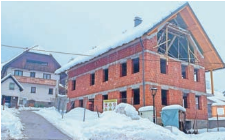
Gradnja in obnova poškodovanih hiš že potekata. / Foto: profil Vsi smo Dovje na Facebooku
