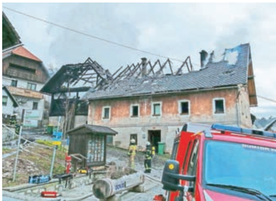
V prvih dneh po požaru je že stekla akcija sanacije poškodovanih objektov, odvoz materiala, rušenje poškodovanih delov objektov ... / Foto: profil Vsi smo Dovje na Facebooku
