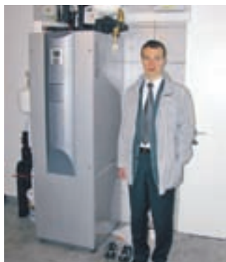
TČ na zemeljski kolektor Utik
