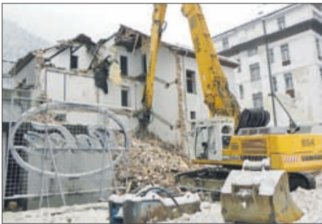
Okvara stroja ob rušenju stare upravne stavbe (7. 1. 2010)
