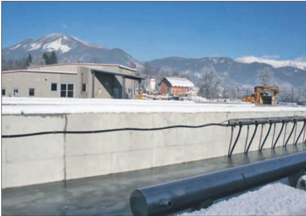
Centralna čistilna naprava na Brezovem bo začela poskusno obratovati ta mesec.
