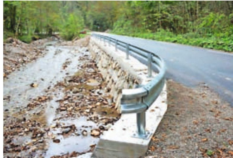
Občina je že v okviru intervencijskih del za zavarovanje življenj in premoženja v dneh po poplavih začela nujno sanacijo doline Ločnice in sanirala usade. / Foto: arhiv Občine Medvode
