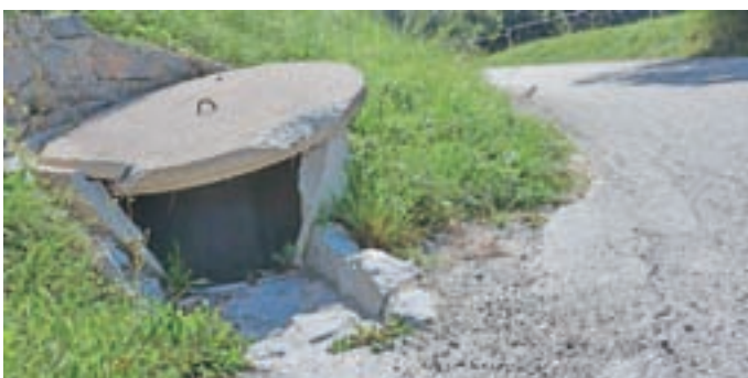
Občan pravi, da poškodovani jaški kazijo podobo kraja in so nevarni.
