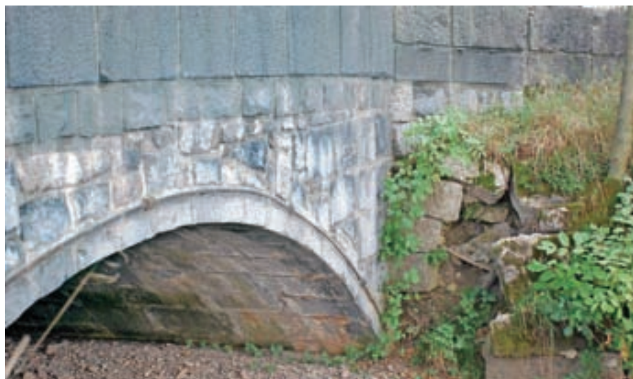
Janez Šušteršič opozarja, da bi bilo treba most – pa tudi celoten zaščiten kompleks – obnoviti. Zaščitni podporni zid neposredno ob temelju mostu se je začel rušiti.
