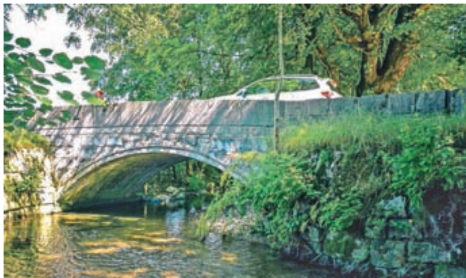
Tometov most so zgradili pred tristo petdesetimi leti. Struga Maveljščice, ki teče pod njim, je pri mostu posebej utrjena z obdelanimi izklesanimi kamni.
