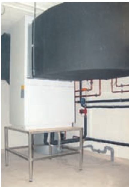
Notranja postavitev toplotne črpalke Termoteknika, ki je smiselna predvsem pri novogradnjah, kjer se že pri projektiranju upoštevajo zahteve za zračne kanale.
