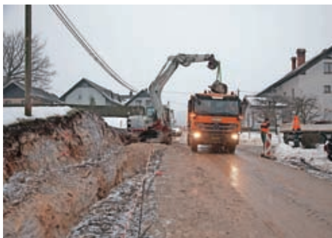
Nadaljuje se obnova ceste od Dolgih Njiv proti Suhemu Dolu. / FOTO: GORAZD KAVČIČ
