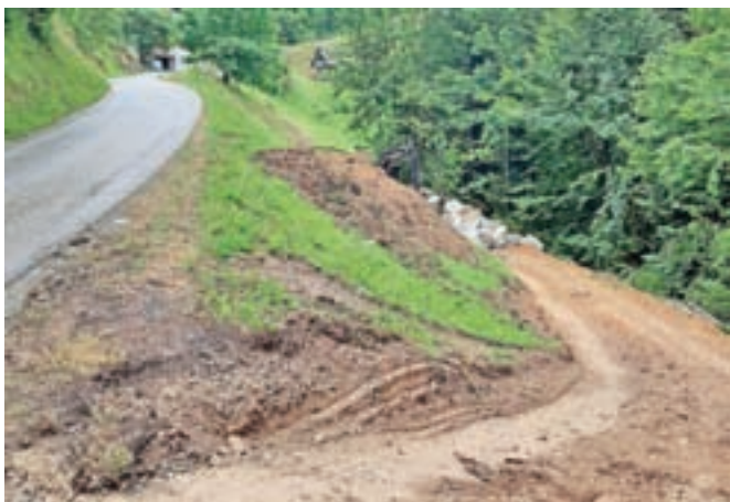
V preteklih dneh se je začela sanacija štirih plazov na cesti Malenski Vrh–Gorenje Brdo. / FOTO: DAMJANA PETERNELJ
