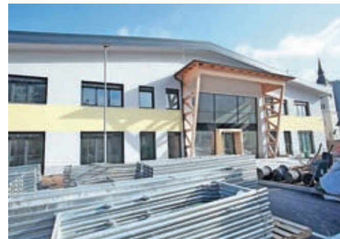
Predvidoma februarja bodo končali gradnjo nove športne dvorane ob šoli. / FOTO: GORAZD KAVČIČ
