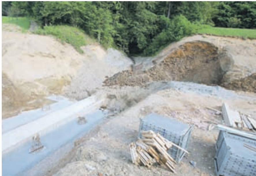
Delovna nesreča se je zgodila zaradi zdrsa zemljine v izkopno jamo temelja pri izdelavi podpornega težnostnega zidu.
