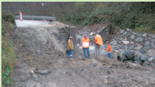
Takole se je porušil oporni zid na cesti v Davčo. / Foto: Gorazd Kavčič
