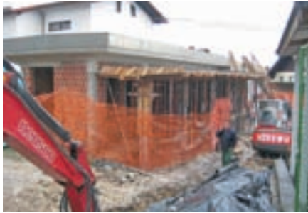
Na mestu nekdanjega Mercatorja raste nov večnamenski objekt, v katerem bodo občinska uprava, pošta in prostori društev.
