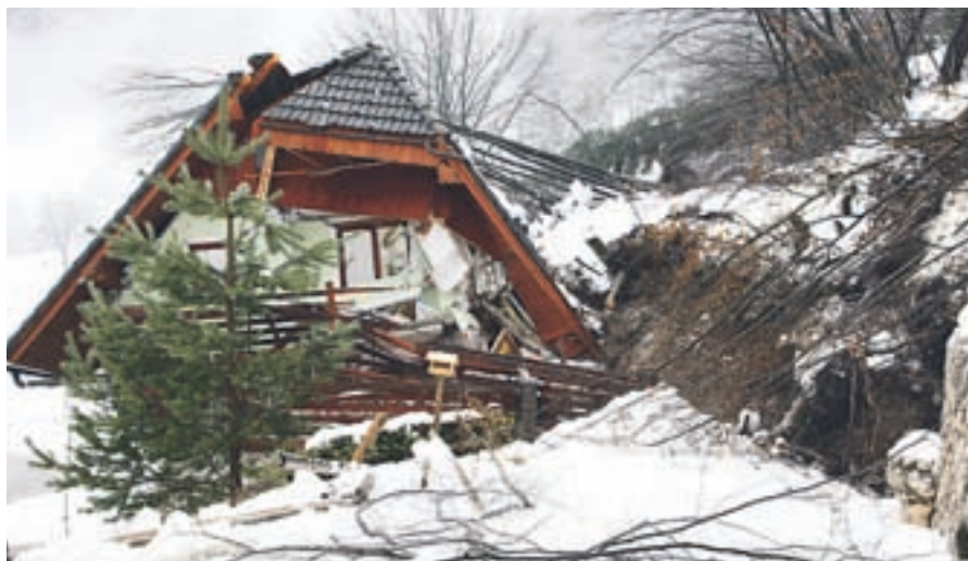
Porušena Bremčeva hiša v Srednji vasi v Bohinju
