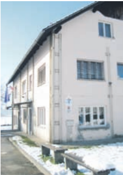
Dotrajana stavba vrtca v Valburgi
