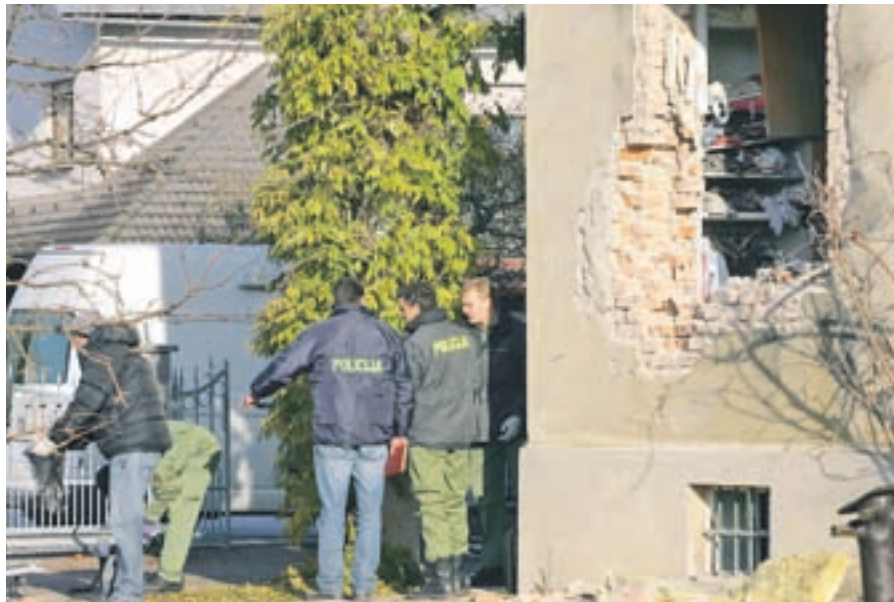
Poškodovana sodnična hiša v Radovljici
