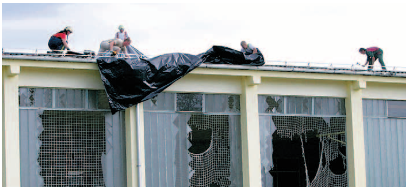
Močan veter je razbil stekla in odkril streho na telovadnici OŠ Vodice. / Foto: Gorazd Kavčič
