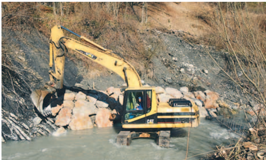
V občini Železniki so odstranjevali posledice poplav.
