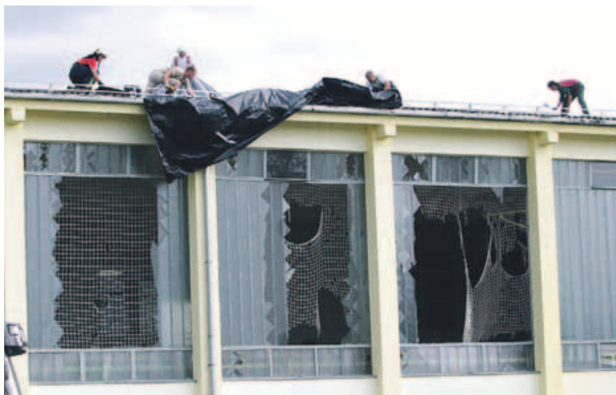
Poškodovana telovadnica v Vodica
