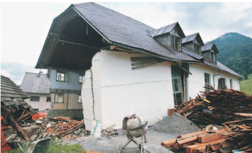
Porušena stena v zadržnem domu na Sorici
