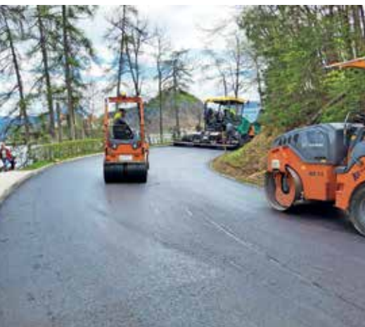
Letos je Občina Bled med drugim preplastila cesto Mlino Pristava–Velika Zaka in sočasno obnovila vodovodno omrežje. / FOTO: OBČINA BLEDE
