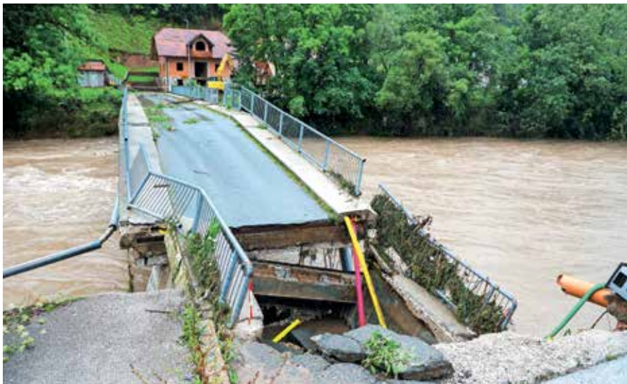
POŠKODOVANIH JE bilo 21 mostov, tudi most na Suhu. / FOTO: TINA DOKL
