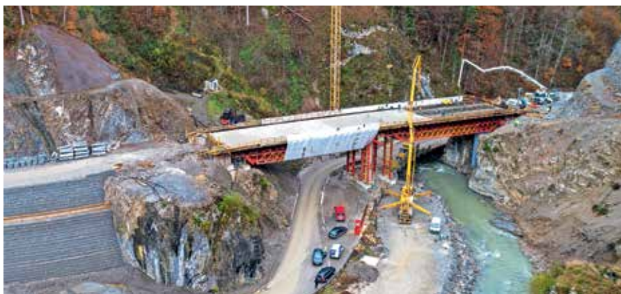
Urejanje območja zadrževalnika vode pod Sušo, kjer so sredi novembra zabetonirali nov most čez bodočo zemeljsko pregrado / FOTO: ARHIV OBČINE ŽELEZNIKI / ANDREJ TARFILA
