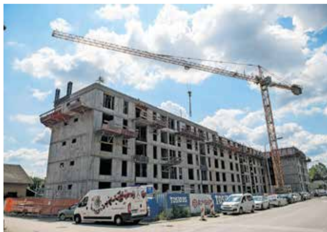
Kompleks D26 je sodobno zasnovan objekt, ki bo vključeval 66 stanovanj. / FOTO: PRIMOŽ PIČULIN
