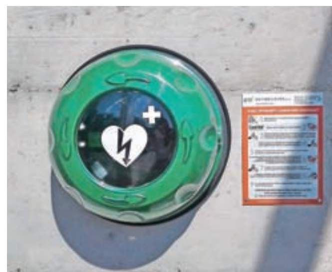
AED na upravni stavbi Komunale Kranj
