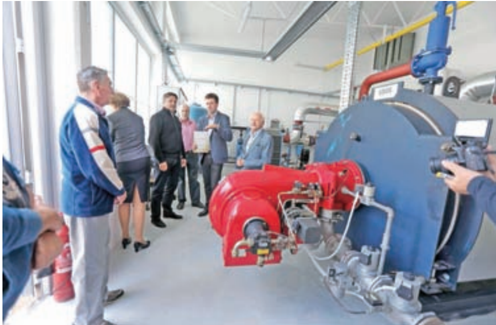
Za ogled prenovljene kotlovnice je bilo veliko zanimanja. / FOTO: TINA DOKL
