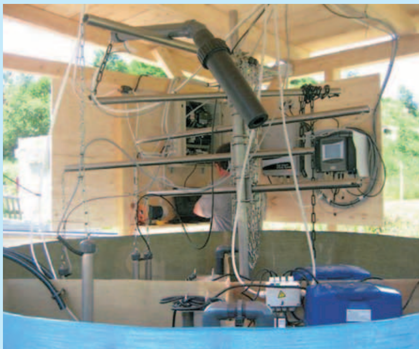
Pilotna čistilna naprava pri odlagališču odpadkov Tenetiše.
