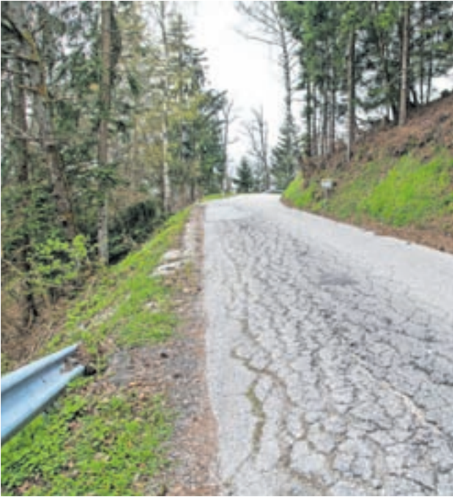
Cesta se na več mestih poseda, manjka pa tudi nekaj sto metrov varovalne ograje. / FOTO: ALEŠ SENOŽETNIK
