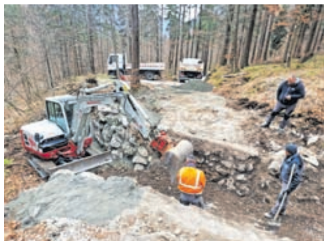
Sanacija mostov v Kamniški Bistrici bo stala slabih 34 tisoč evrov. / FOTO: OBČINA KAMNIK
