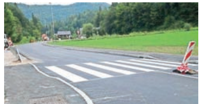
Odsek ceste med Markovim in Virom ob glavni cesti ima nov pločnik in novo asfaltno prevleko. / FOTO: JASNA PALADIN
