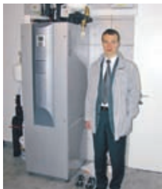
TČ na zemeljski kolektor Utik
