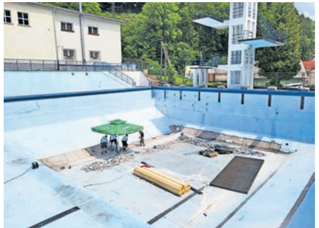
V skladu s projektno dokumentacijo in priporočili ZRMK so začeli opravljati posege, ki bodo statično utrdili stene bazena. / FOTO: OBČINA JESENICE
