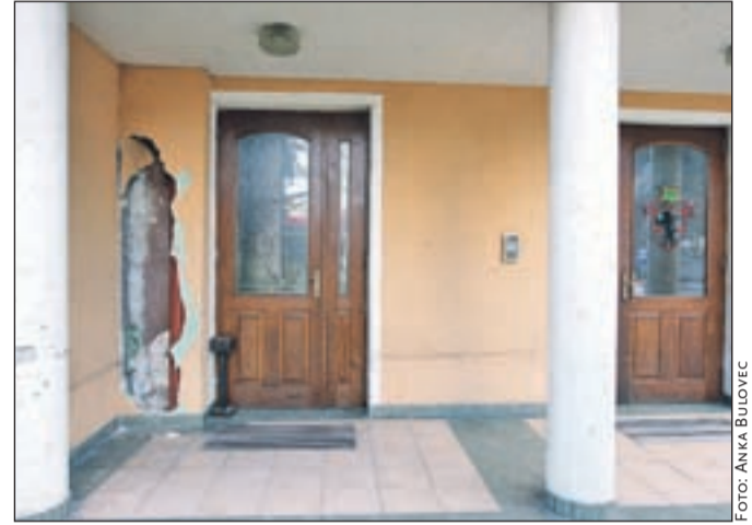
Sledi vandalizma so še vedno vidne pri vhodu v Kazino.
