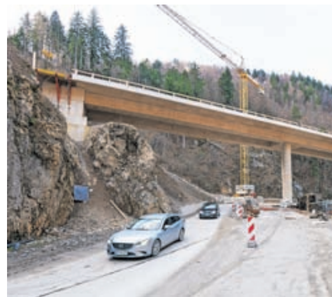
Občasne kratkotrajne popolne zapore državne ceste pod Sušo so predvidene od 26. februarja do 30. aprila. Režim bo enak kot v preteklosti. / Foto: Simon Benedičič
