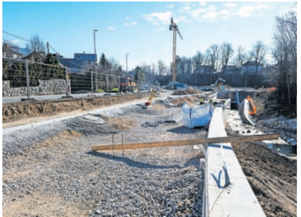
V času zahtevnih gradbenih del na krožnem križišču Betin bo promet potekal po Betinovem klancu, pri čemer bo vzpostavljena polovična zapora v dveh fazah. / Foto: Primož Pičulin
