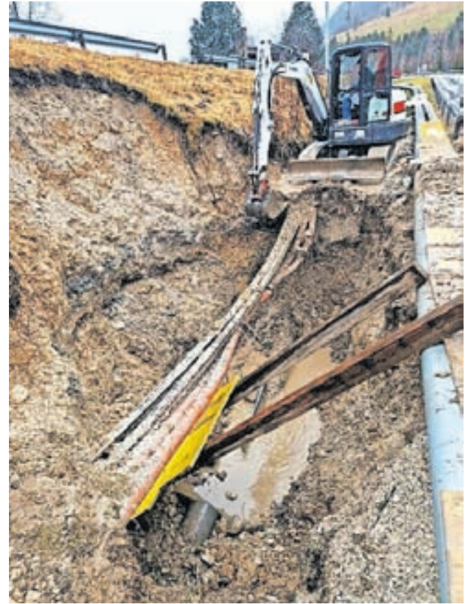
V bližini platoja Karavanke je dvakrat počila dovodna cev vodovoda Peričnik. / Foto: arhiv Jeko
