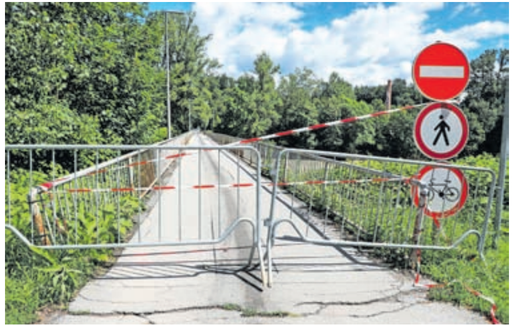
Na prioritetnem seznamu investicij za leto 2024 je tudi sanacija mostu pri nekdanji Planiki, ki je od avgustovskih poplav zaprt. / Foto: Tina Dokl
