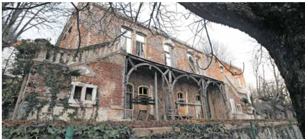
Vila Rikli na Bledu je primer propadanja stavbne dediščine. / Foto: Gorazd Kavčič
