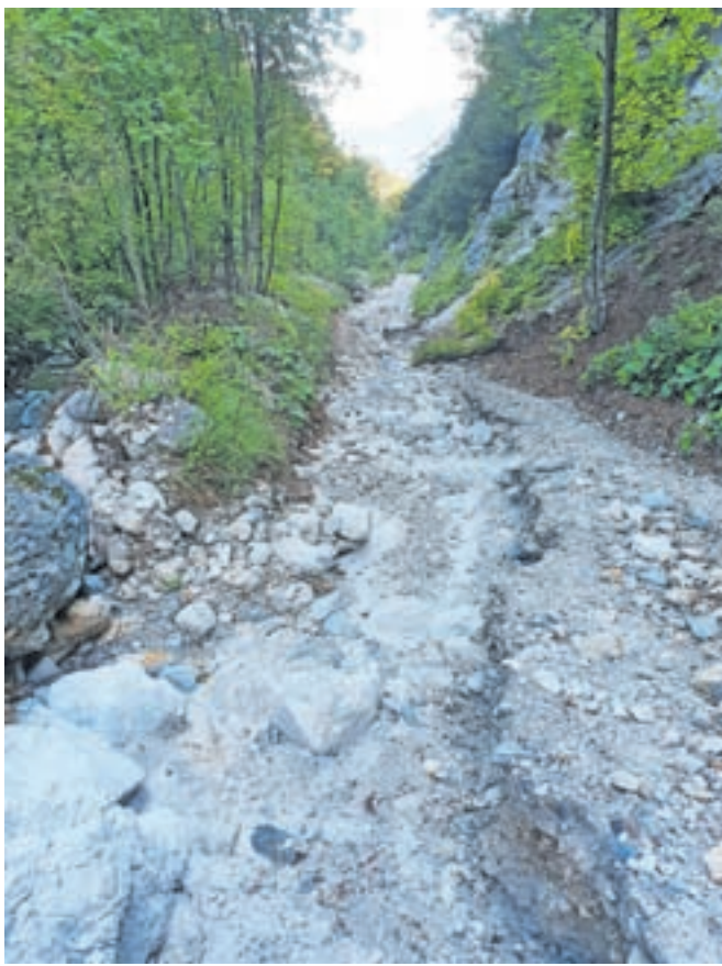
Poškodovana gozdna cesta na območju Drage
