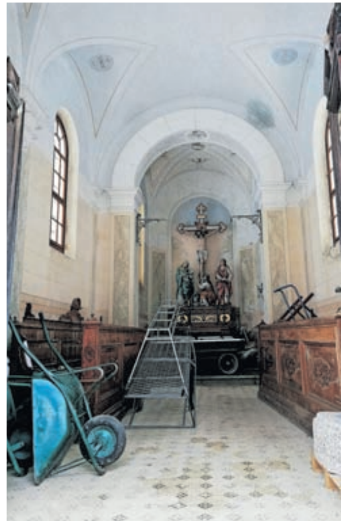
Notranost kapele pred posegom. Letos so odstranili lesene elemente in jih odpeljali v restavratorski atelje, nato pa je sledil poseg na dotrajenih apnenih ometih in poslikavi.
