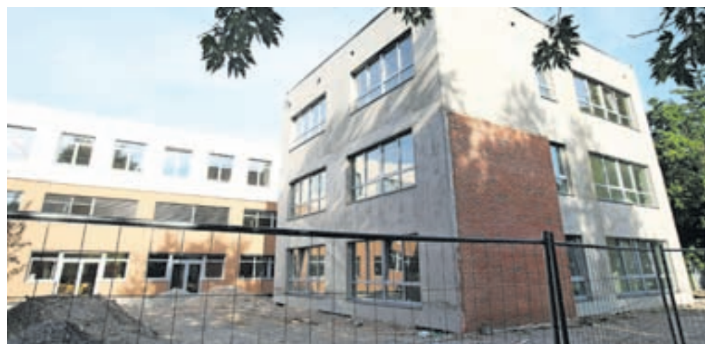
Gradnja šole za zdaj stoji, ampak na Občini Škofja Loka se nadejajo, da bo kmalu spet stekla. / Foto: Gorazd Kavčič
