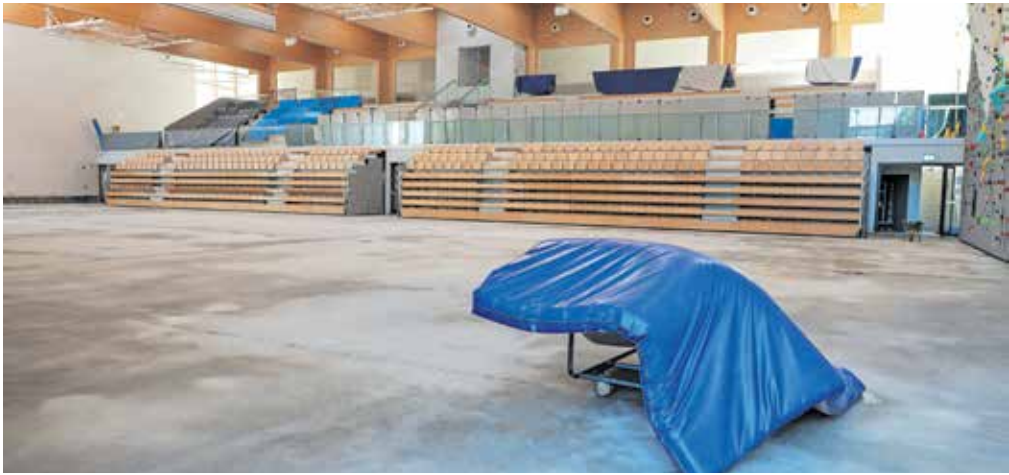
V športni dvorani v Mengšu je treba nadomestiti parket, ki ga je uničila poplava, delno pa so bile poškodovane tudi stene. / Foto: Tina Dokl
