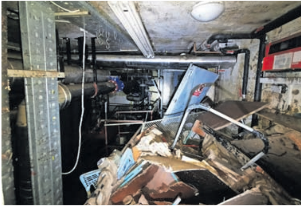
Razdejanje ob vhodu v kotlovnico / Foto: arhiv Šole
