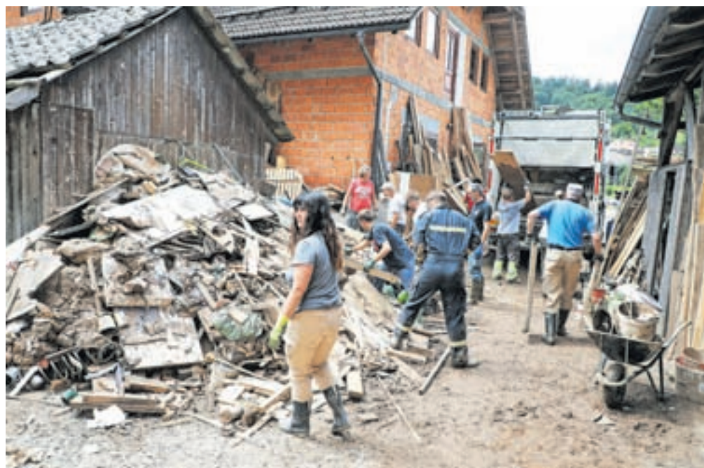
Poplave so za seboj pustile kaotično razdejanje. / Foto: Tina Dokl
