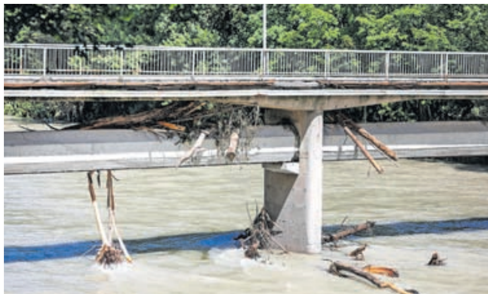
Poškodovana cev pod mostom pri nekdanji Planiki. Če se nalivi ponovijo, bi lahko prišlo do take poškodbe, da bi cev odneslo in s tem tudi kanalizacijo. / Foto: Tina Dokl
