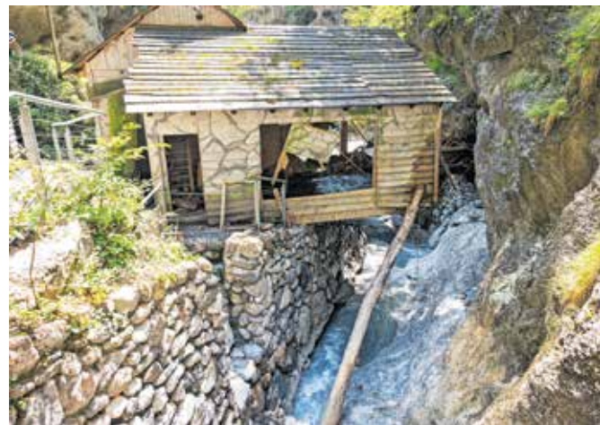
V neurju 13. julija je bila znova obsežno poškodovana Partizanska bolnica Franja. / Foto: Bor Slana/STA
