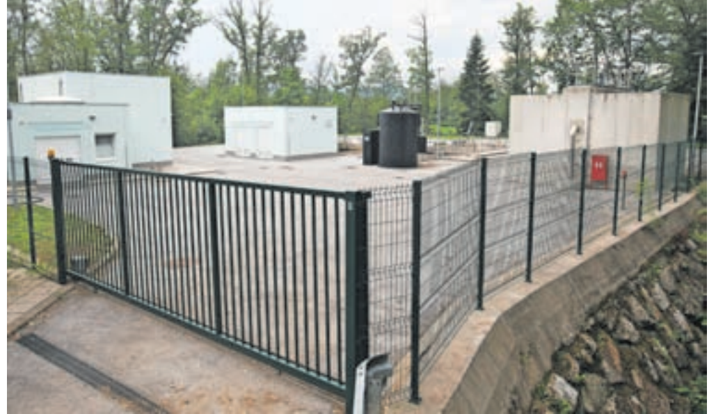
Kranjska občina je Občini Šenčur v odkup ponudila njihov celotni lastniški del v primarnem kanalizacijskem vodovodu v občini Šenčur in lastniški del v Čistilni napravi Trboje (na fotografiji). / Foto: Gorazd Kavčič
