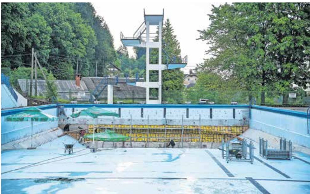
Jeseniški bazen Ukova naj bi odprli konec meseca, saj v teh dneh poteka obnova poškodovane bazenske školjke. / Foto: Nik Bertonec
