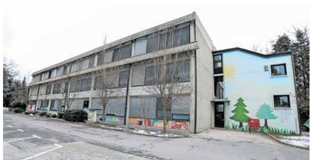
Osnova šola prof. dr. Josipa Plemlja Bled je dotrajana in nujno potrebuje obnovo oziroma je potrebna novogradnja. / Foto: Tina Dokl
