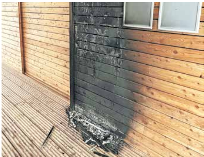
Škoda bo precejšnja, saj je bil poškodovan macesnov les.
