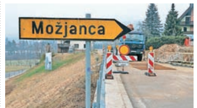
Na Možjancu so začeli graditi vodovod, obvoz sedaj poteka čez Štefanjo Goro.
