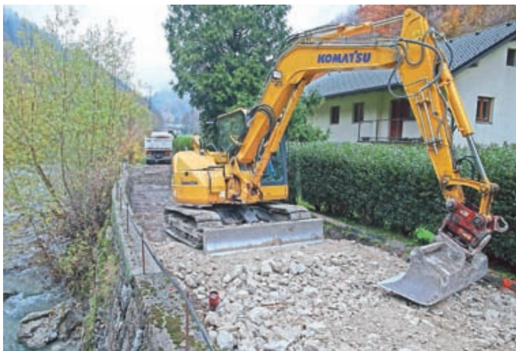
Gradnja kolesarske steze na območju Jesenovca. Celoten projekt morajo dokončati do sredine prihodnjega leta. / Foto: Gorazd Kavčič
