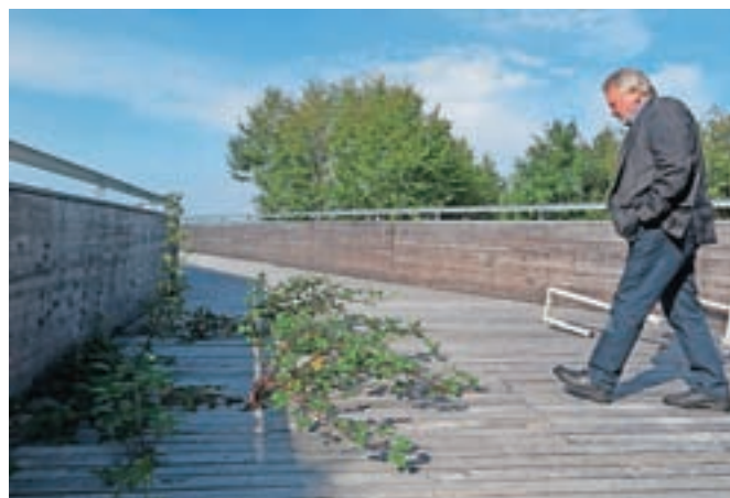
Razgledna ploščad kot enostavni objekt (še) ni namenjena javni uporabi, zato jo je že začelo preraščati robidovje.
