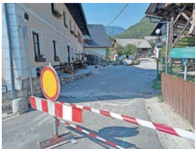
Prostor med gostilno Mihovc in Planšarskim muzejem bodo na novo tlakovali in opremili s klopmi, lučmi in koši ter manjkajočo gospodarsko javno infrastrukturo. Obnova bo predvidoma zaključena še to jesen.
