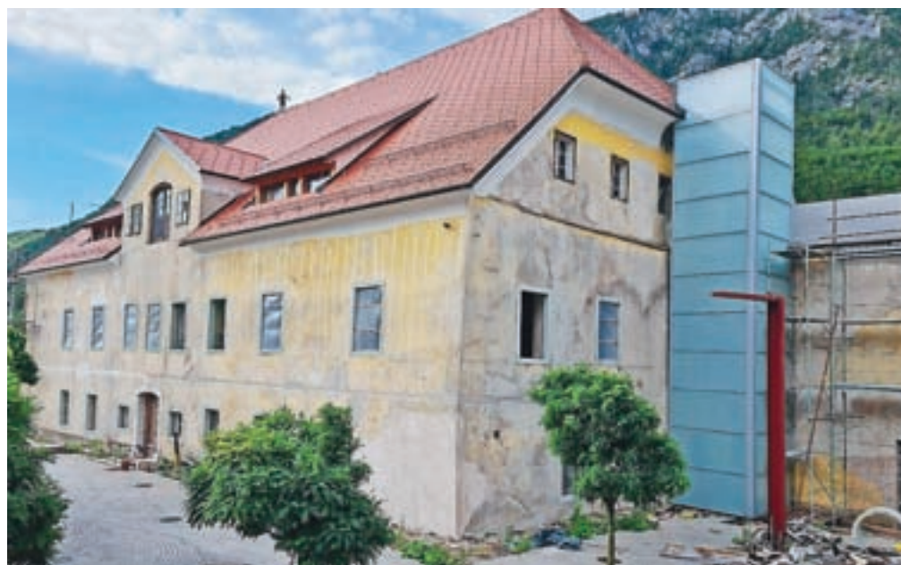
Obnovitvena dela so ustavljena, ker je stavba okužena z lesno gobo, z razpisom pa zdaj iščejo izvajalca, ki bo izvedel sanacijo.
