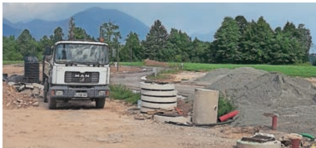
Komunalna infrastruktura znotraj zazidalnega načrta Koritno je dokončana, zdaj jo urejajo še na glavni cesti skozi naselje. Dela bodo po načrtih zaključena v septembru.
