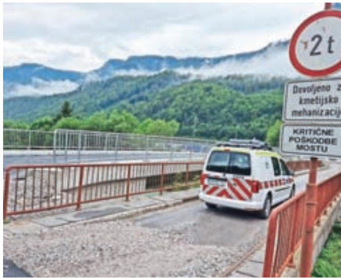
Stari, dotrajani most na lokalni cesti na Hrušici in ob njem novi, ki ga bodo odprli konec meseca.
