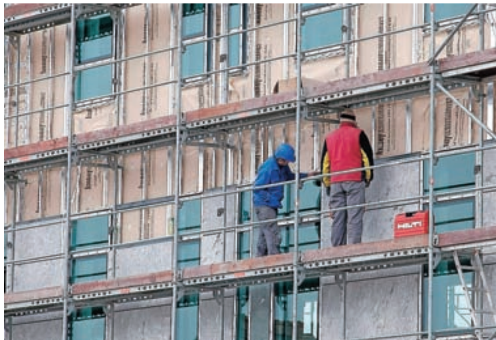
Nova gradbena zakonodaja naj bi še olajšala gradnjo objektov. / Foto: Gorazd Kavčič
