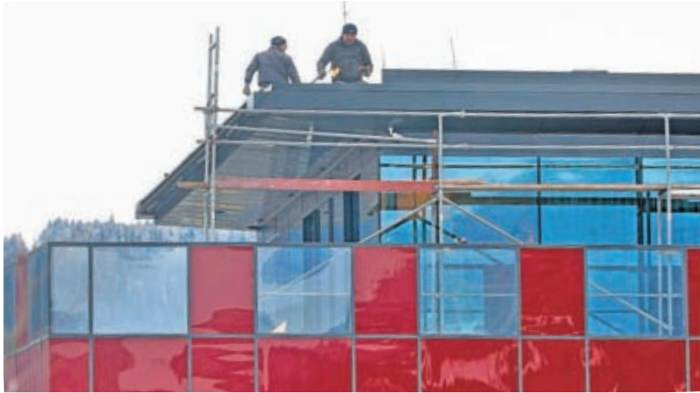
Že vse od pomladi se v Radovljici ukvarjajo s sanacijo strehe nove knjižnice, ki naj bi bila zdaj vendarle uspešno končana. Izvajalec ureja še strop kletne etaže, zaradi česar so odstranili tlak pred vhodom v knjižnico.
